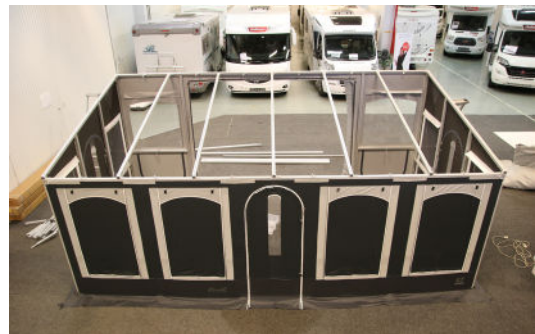
*7 - De två takstolarna nr 8 fästs i bakväggens överliggare på den tredje C-vinkeln ifrån kanten på respektive sida.
