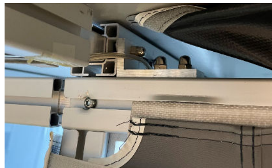
*8 - De två takstolarna ska nu fästas på frontväggens överliggare genom att lägga i en T-skruv och sedan fästa i tredje B-vinkeln från respektive kant.
